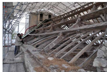
La charpente est découverte. Elle présente des signes de fatigue.
